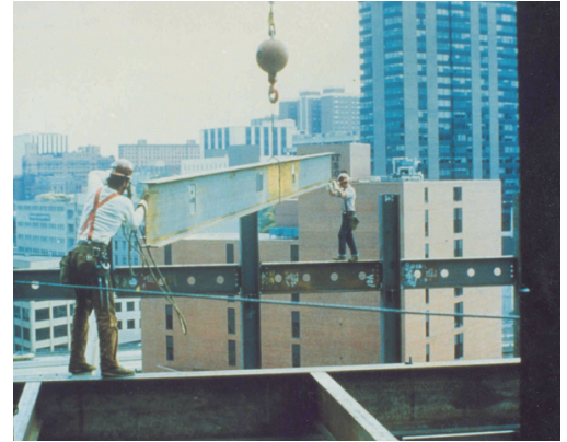
F70: Zo moet het niet!! Het veiligheidsharnas is niet verbonden met de verbindingslijn.
